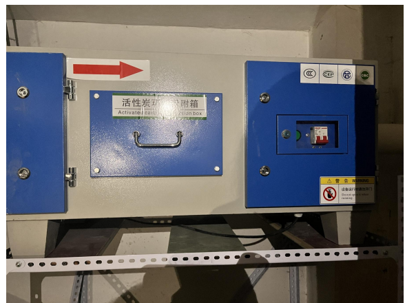
水处理设施活性炭吸附装置
